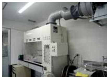
化学処理室 ドラフトチェンバー
